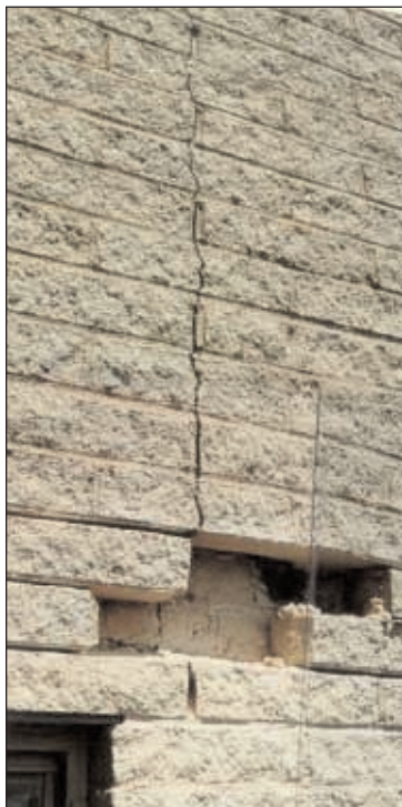
Exemple de fissure et de trou d'exploration
