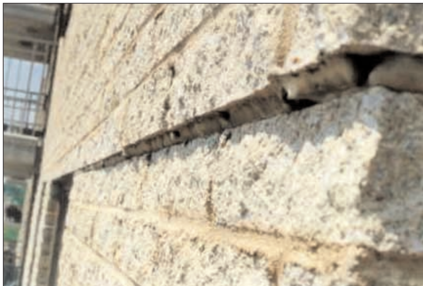
Exemple de désaxement du parement de brique causé par l'accumulation de glace.
